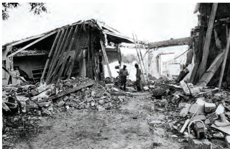
FIG. 7 I danni subiti dai locali caldaia e i rottami della stessa (coll. Ezio Cociancig).
